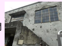
旧日立航空機株式会社変電所 無数の弾痕が確認できる外壁 写真：東大和市立郷土博物館
